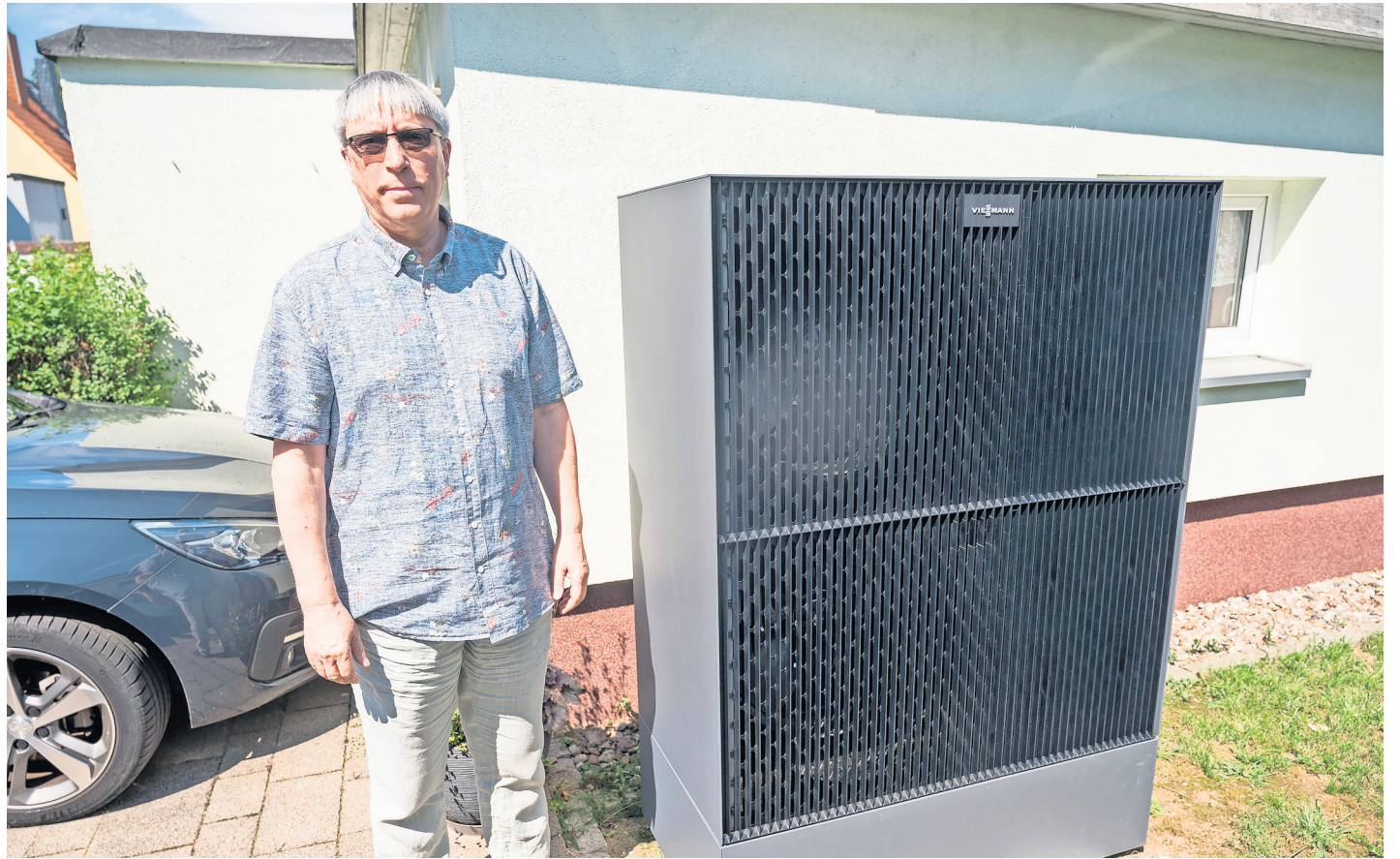
Dirk Heinzelmann (64) aus Rostock vor der installierten Wärmepumpe auf seinem Grundstück.
