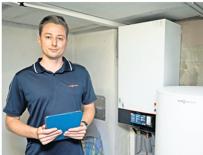
Heizungsanlagensanitärmeister Henry Grünwald (28) steht vor der Inneneinheit der Wärmepumpe.
